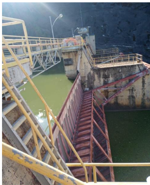
Figura 3 - Vertedouro com comporta segmento (Fonte: Própria).
