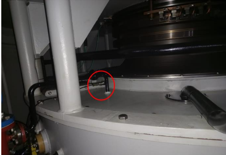
Figura 33- Acelerômetro montado radialmente em estrutura rígida próxima ao mancal de escora, posição de montante (Fonte: própria).
