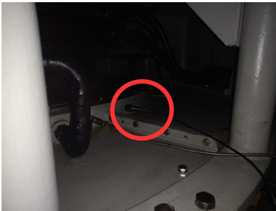
Figura 34- Acelerômetro montado radialmente em estrutura rígida próxima ao mancal de escora, posição direita (Fonte: própria).
