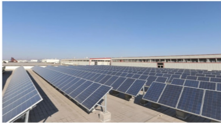
Figura 8: Sistema Fotovoltaico tipo BAPV
