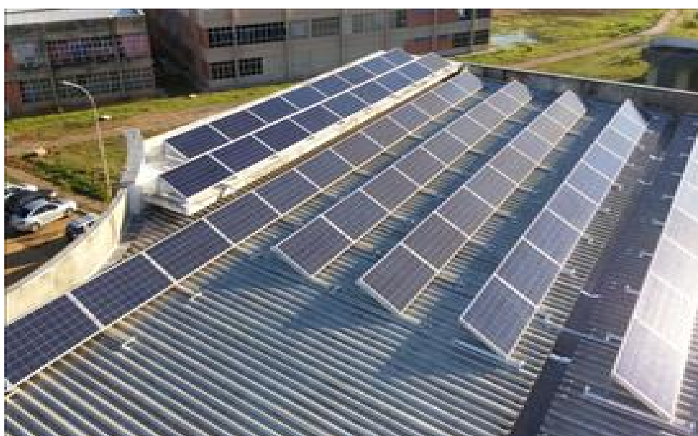
Figura 27: Usina Fotovoltaica CERIn
