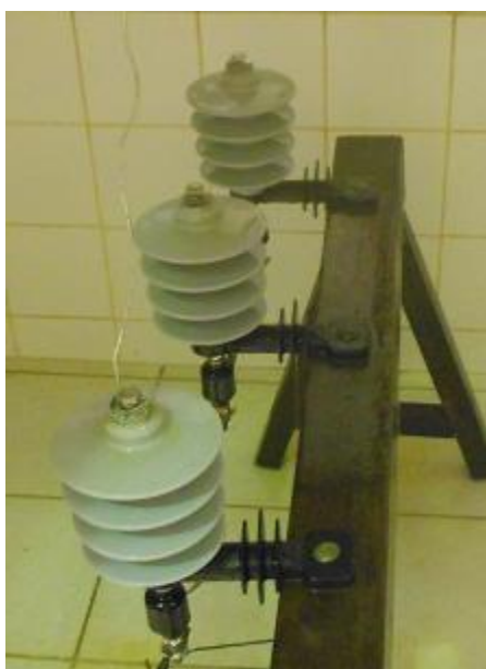
Fig. 5.13 (a) - desligadores eletromecânicos conectados aos para-raios
