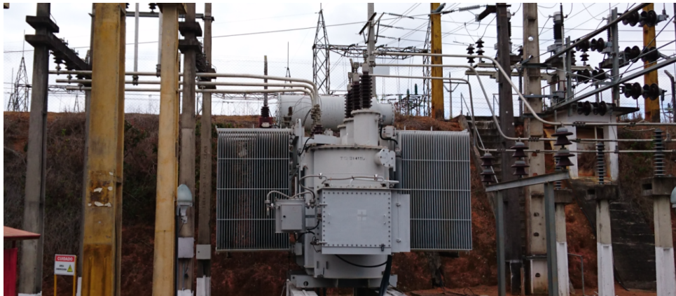
Figura 18 – Transformador 69 kV/11,4 kV da SE Julius Arp.
