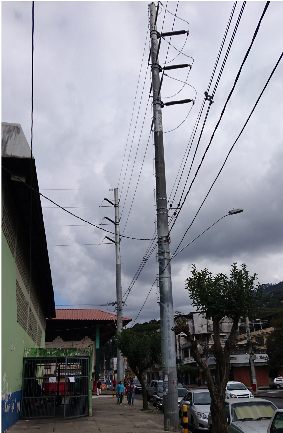
Figura 11 – Foto de estrutura com compartilhamento de circuitos.
