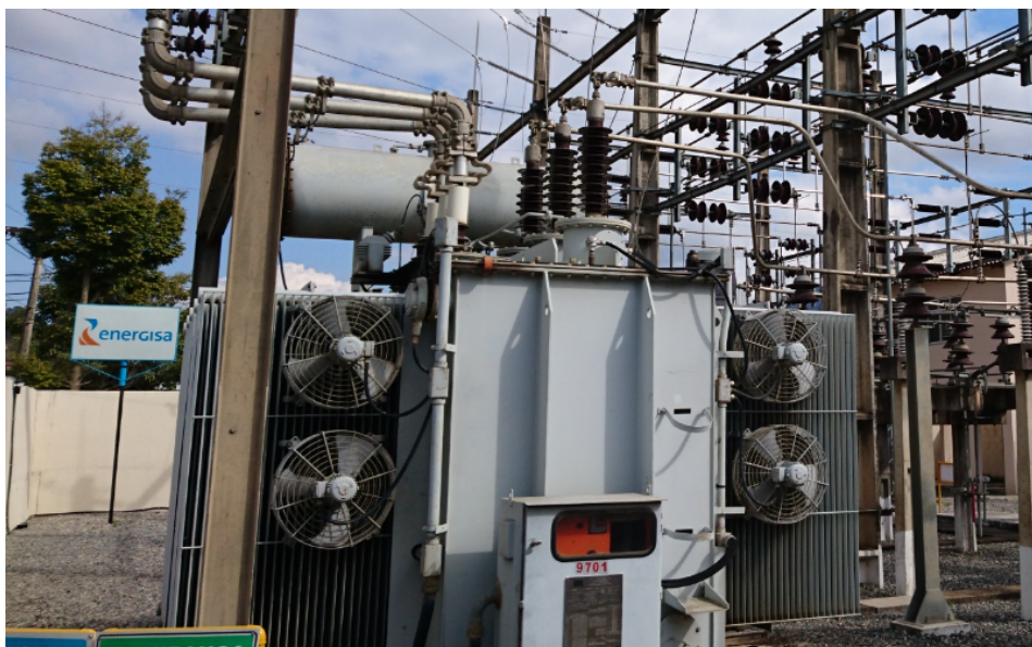
Figura 19 – Transformador 69 kV/11,4 kV da SE Conselheiro Paulino.
