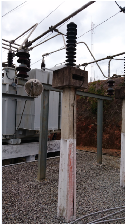
Figura 20 – Para-Raio de 69 kV Instalado na Subestação Julius Arp - Nova Friburgo.
