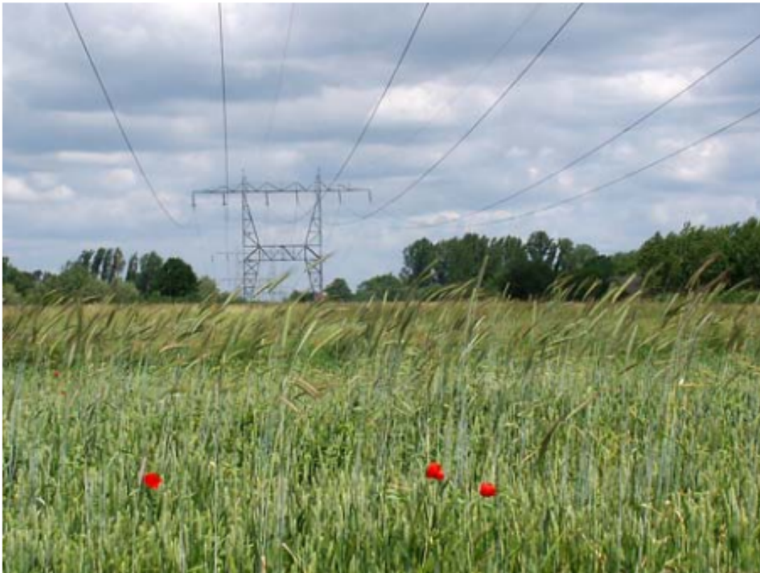
Figura 4 – Linhas de transmissão de 220 kV KLI – NIZ e 110 kV KLI – POL instalados no mesmo suporte [3].
