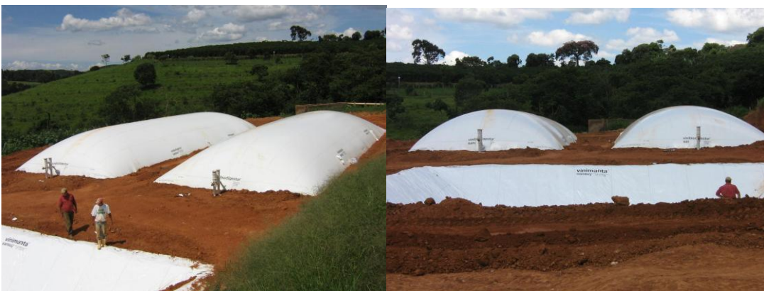
Figura 3.5 - Biodigestores já instalados e inflados com ar
