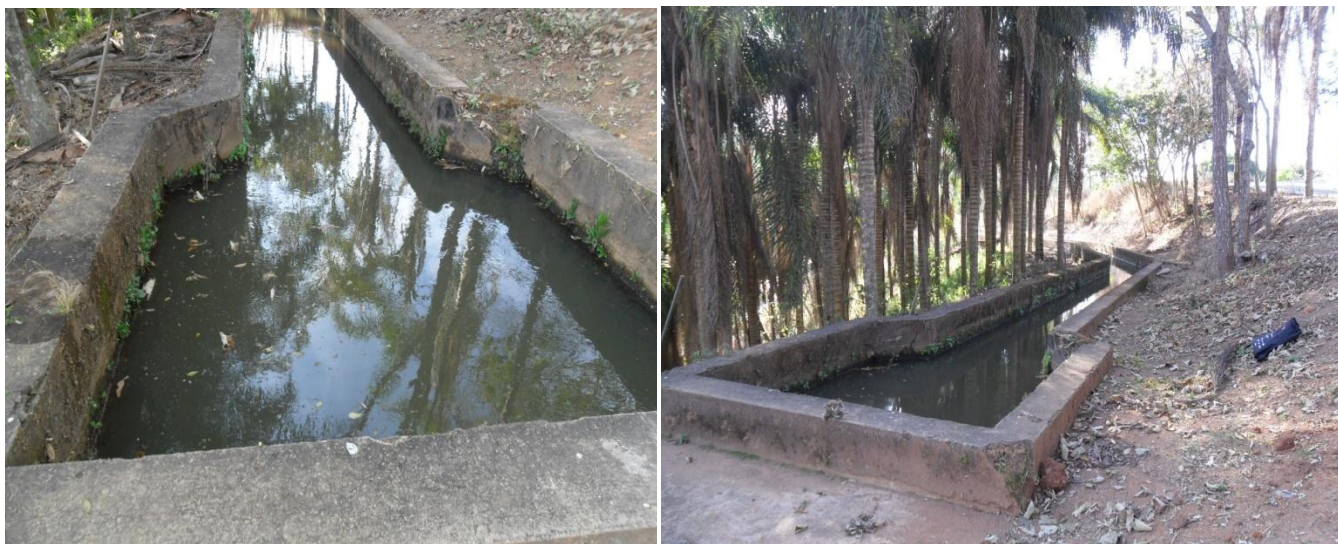
Figura 2.11 - Câmara de carga
