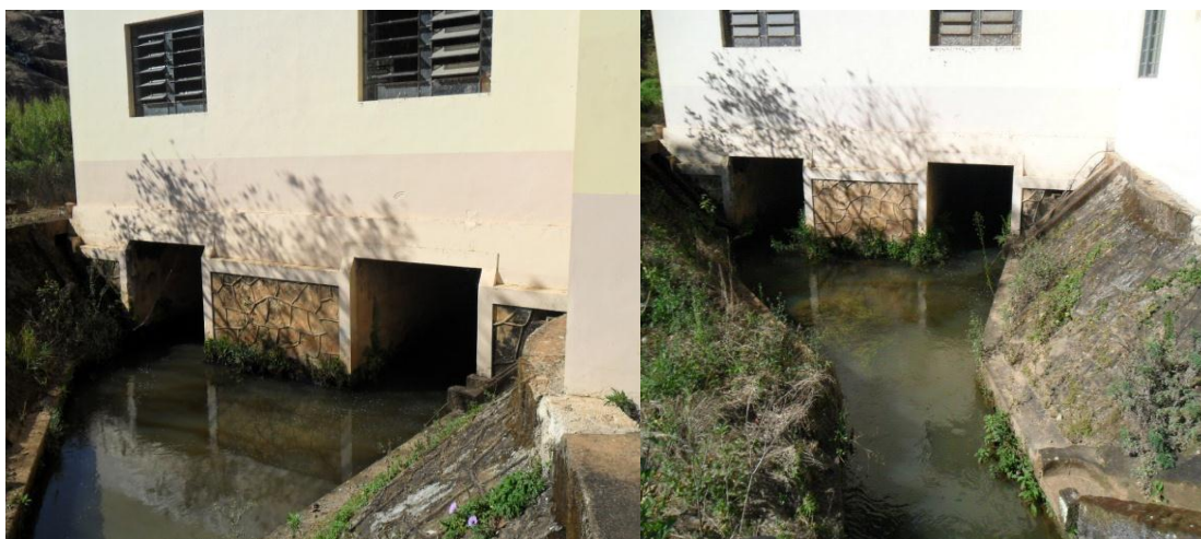
Figura 2.20 - Canal de fuga
