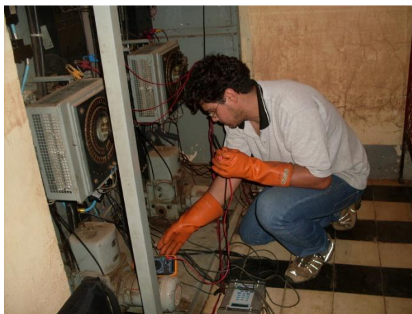
Figura 3.1 – Instalação do medidor de grandezas elétricas para monitoramento da geração
