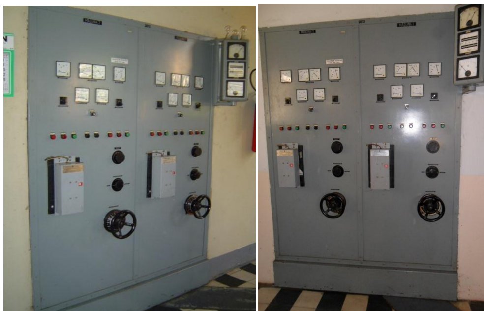
Figura 2.19 - Quadro de comando e proteção
