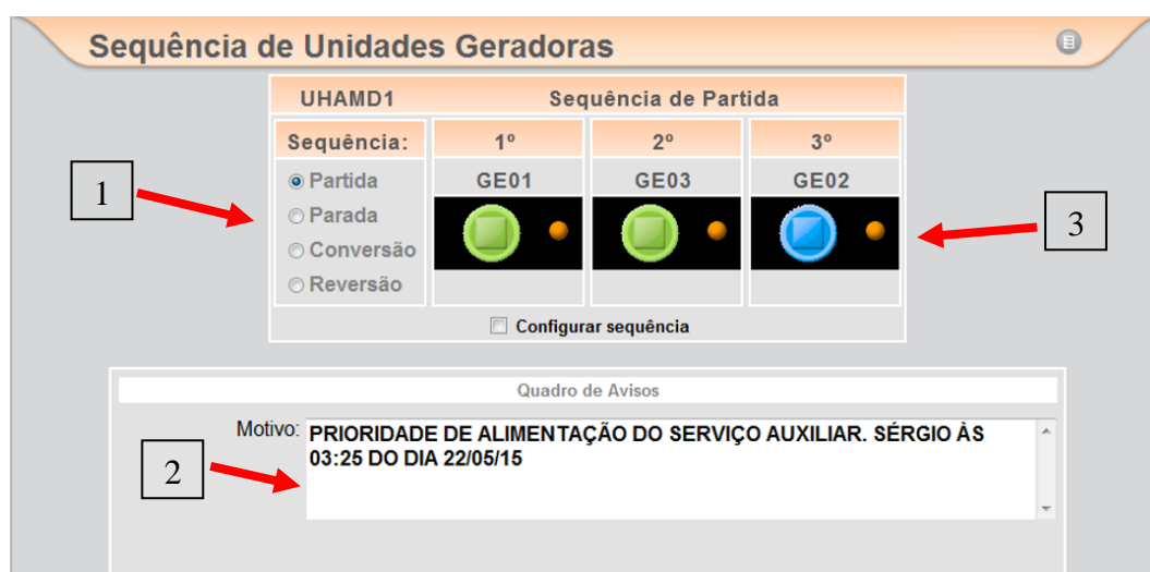
Figura 60 – Primeira tela de controle de movimentação de unidades geradoras (Fonte: SSCD, 2017)
