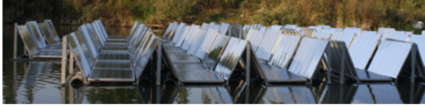
Figura 2.10 – Floating Tracker Cooling Concentrator, instalação construída na Itália
