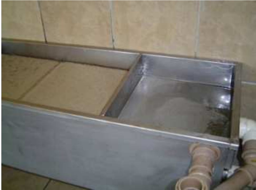
Figura 2. 14 - Decantadores (Parte Final)
