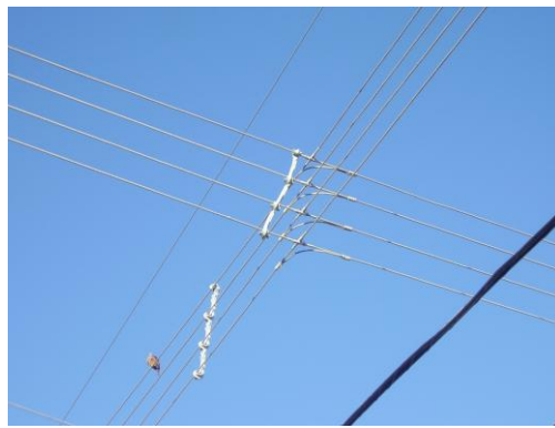
Figura 4 - Barramento Secundário (rede aérea nua)
