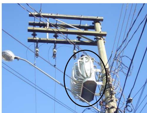
Figura 3 - Transformador de Distribuição 15kV
