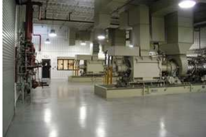
Figura 3.5. Turbina a gás (USEPA, 2009).
