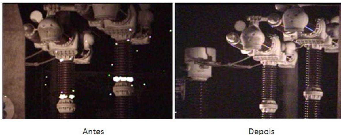
Figura 3.10 – Ensaio de detecção de corona por UV na coluna de isoladores do disjuntor antes e depois da limpeza
