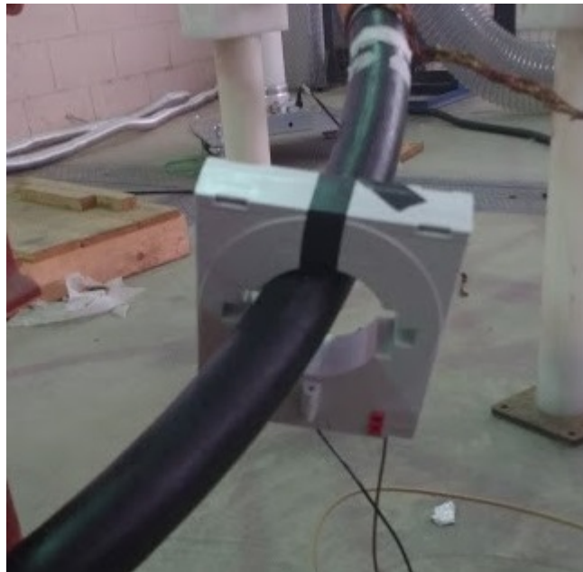
Figura 19 – Transformador de corrente - relação 2500:5 - instalado no cabo de alimentação de corrente
