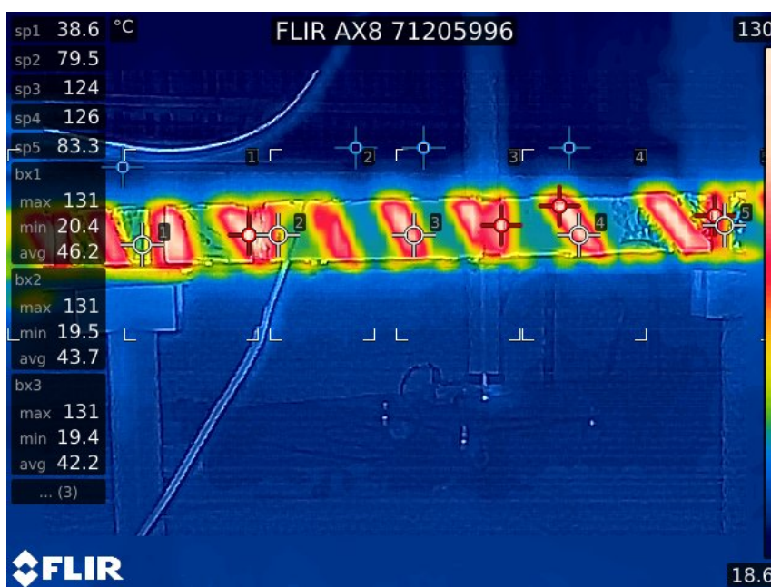
Figura 23 – Foto capturada pela câmera termográfica
