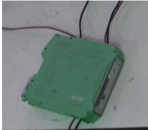
Figura 20 – Transdutor de corrente - entrada 0 a 5A; saída 4 a 20mA
