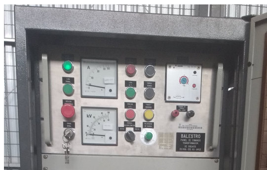
Figura 9 – Painel de comando da fonte de tensão
