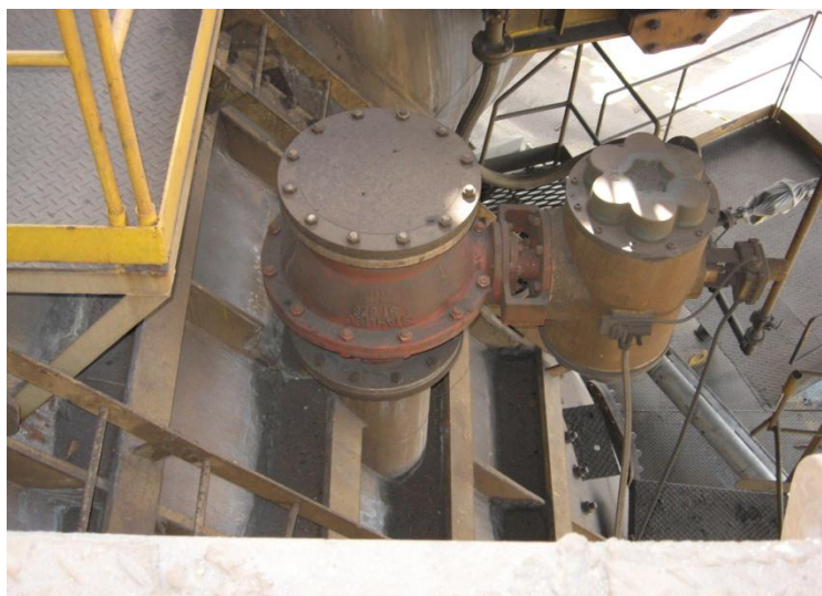
Figura 2.1 - Medidores de nível tipo radar sem contato utilizado na carga de autoforno da Companhia Siderúrgica Nacional, em Volta Redonda ó RJ.
