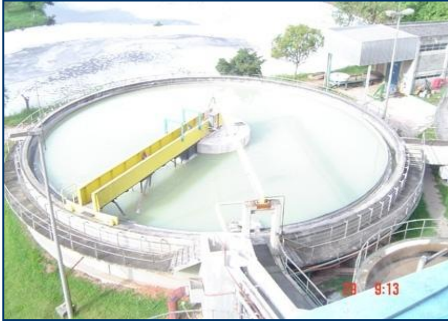
Figura 2.12 - Decantador. Fonte: Suzano, (2006).
