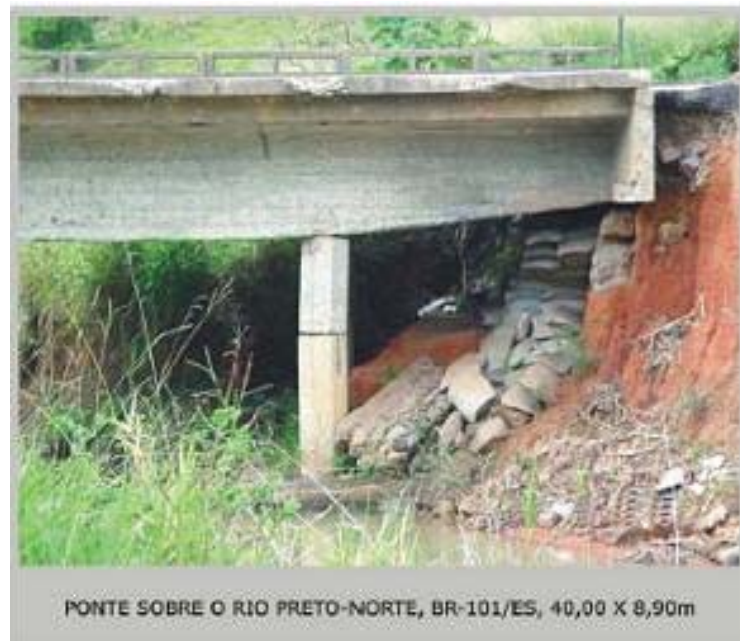
Figura 1: foto de um pilar a ponto de entrar em ruína (ponte sobre o rio preto-norte, BR-101/ES). Fonte Manual de inspeção de pontes rodoviárias-DENIT (2004).
