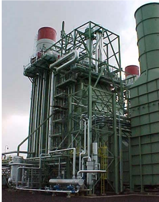
Figura 6.3 – Caldeira de Recuperação sem Queima Suplementar.
