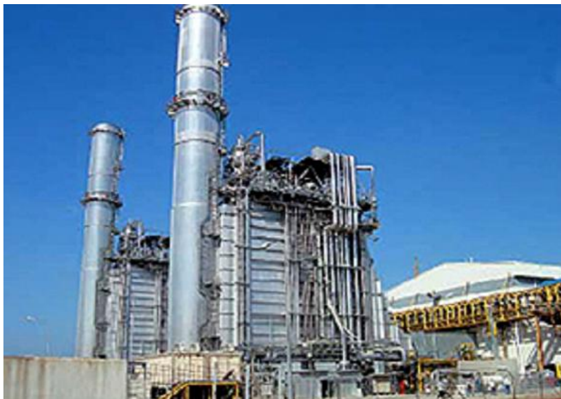
Figura 6.5 – Caldeira de Recuperação Vertical.
