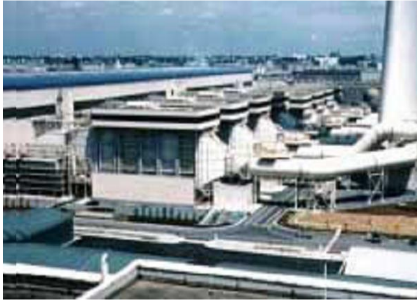
Figura 6.4 – Central Térmica com Caldeira de Recuperação Horizontal.
