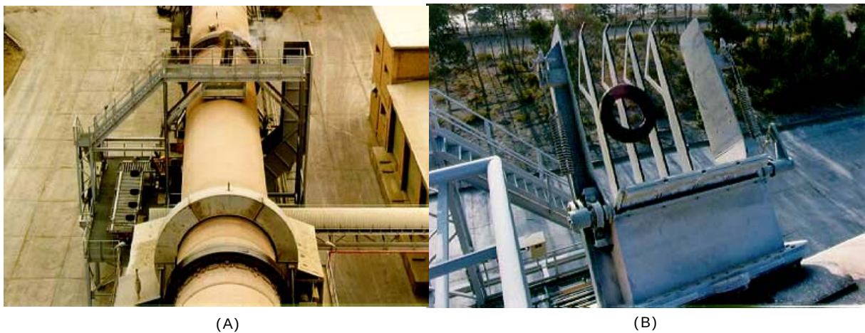
Figura 48 - (A) Sistema de introdução de pneus no meio do forno (B) Instalação de válvula pêndulo no meio do forno. Fonte: ERAtech – TMI Systems (2007).
