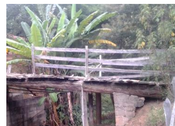
c) Ponte de acesso de moradores, em más condições
