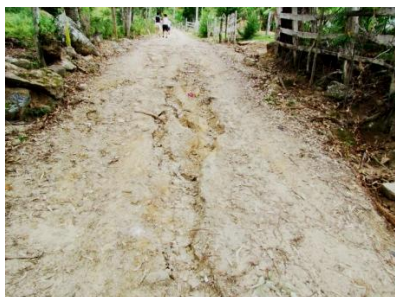
a) Leito da estrada com irregularidades, com rachaduras e buracos.
