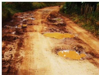
a) Pista com excesso de buracos e atoleiros
