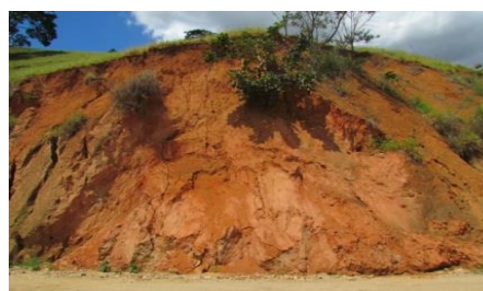
b) Desmoronamento de terra na pista com risco de queda de árvores.
