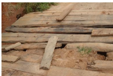
a) Ponte para passagem de veículos em más condições de conservação
