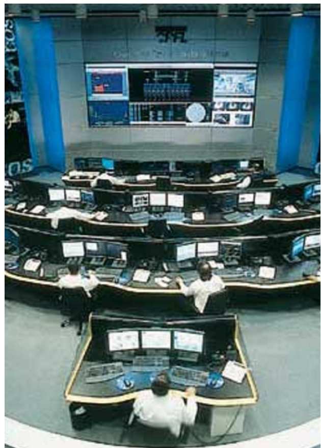
Figura 1 – COS: Centro de Operação do Sistema
