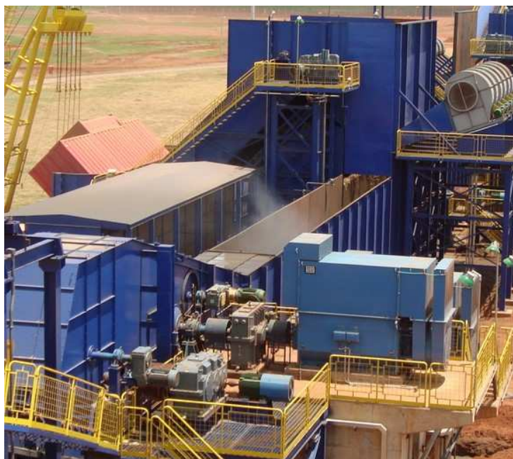
Figura 3.6 – Esteira de preparo da cana, em destaque o motor do desfibrador.
