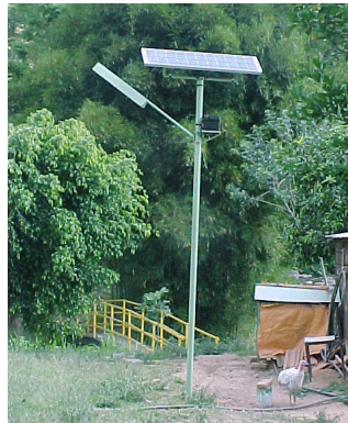
Figura 6.3 – Painel fotovoltaico para iluminação externa.
