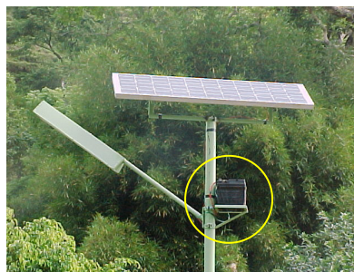
Figura 6.4 – Poste com iluminação fotovoltaica em detalhe mostrando o painel, a bateria de armazenagem de energia e as lâmpadas.
