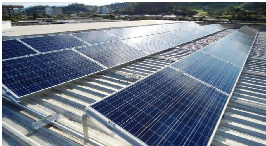
Figura 5.6 – Conjunto de 31 painéis fotovoltaicos no CERIn.
