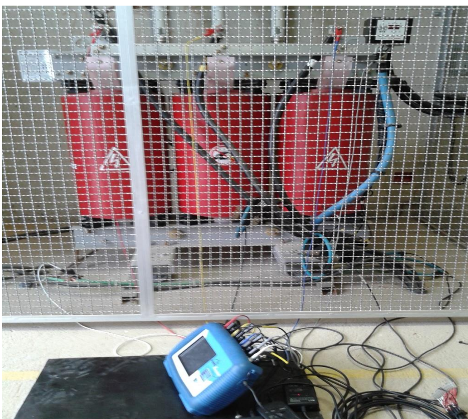
Figura 5.12 – Medição de qualidade de energia na saída do transformador de distribuição do CERIn.
