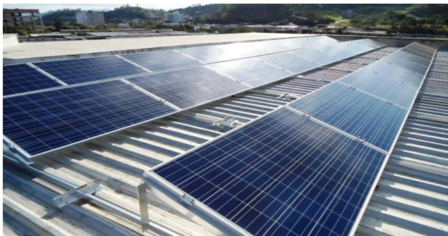
Figura 3.4 – Conjunto de 15 kW p instalado no telhado do prédio onde se localiza o CERIn.
