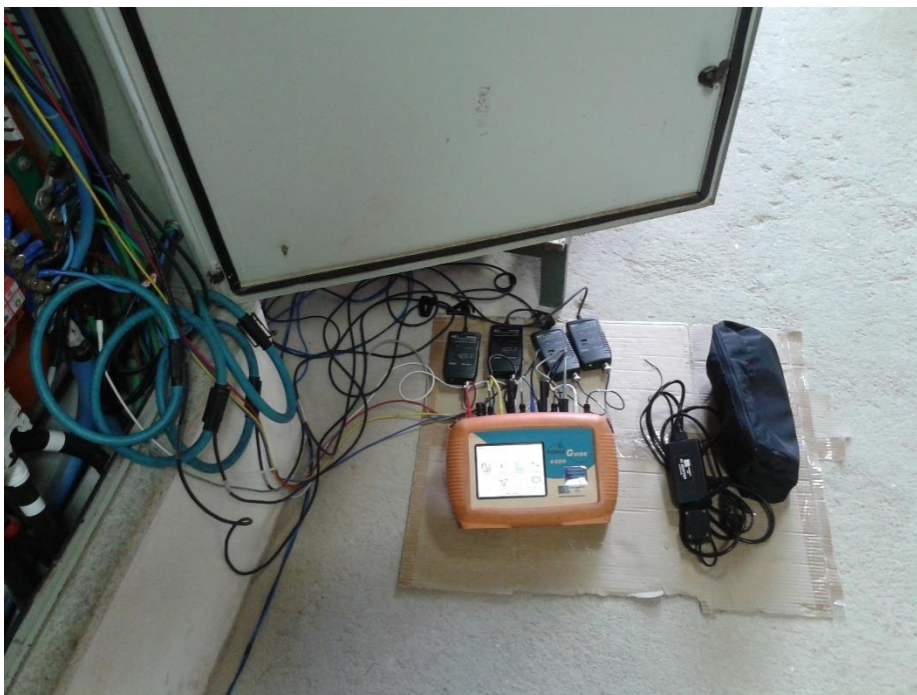
Figura 5.11 – Medição de qualidade de energia na saída do PV.
