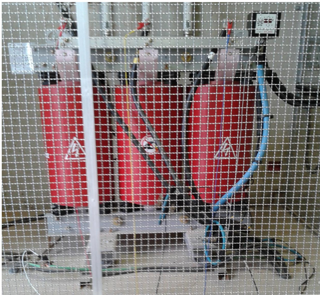
Figura 5.10 – Transformador a seco de 150 kVA do CERIn
