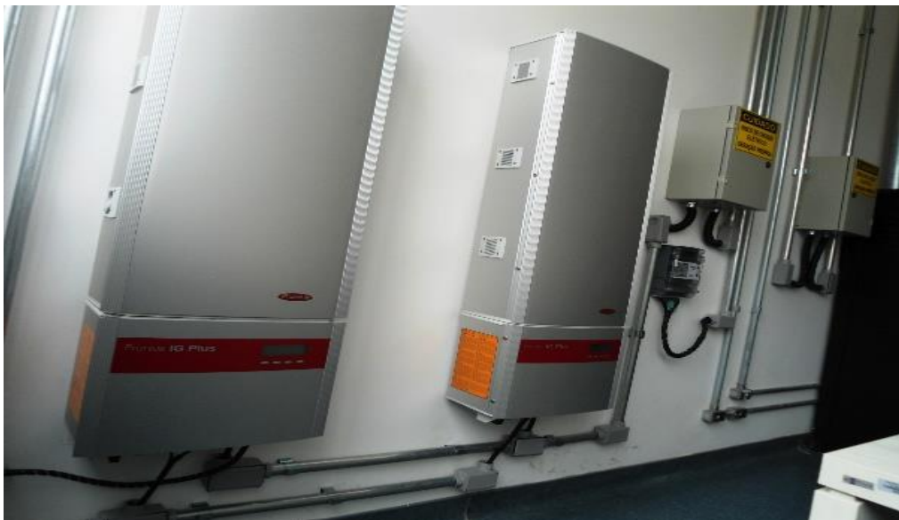
Figura 5.9 – Conjunto de 2 inversores para o PV do CERIn (FRONIUS, 2015).
