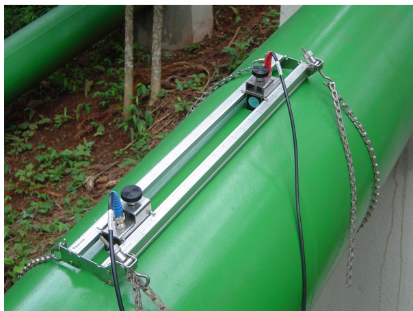
FIGURA 69 - Transdutores do medidor de vazão ultra-sônico, entrada da BFT
