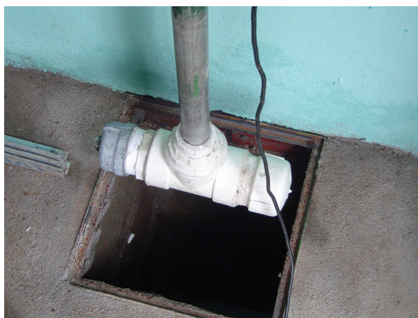
FIGURA 73 - Transdutor de pressão em poço tranquilizador, canal de fuga
