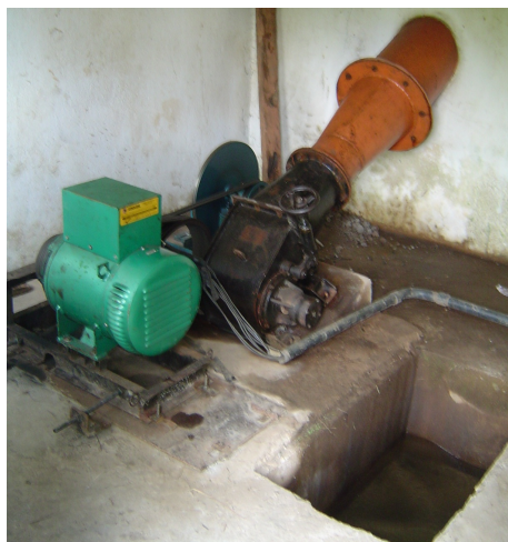
FIGURA 43 - Desfavoráveis condições do grupo gerador e casa de força
