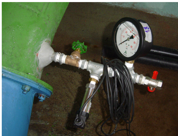
FIGURA 72 - Transdutor de pressão e manômetro de Bourdon, entrada da turbina Michell-Banki
