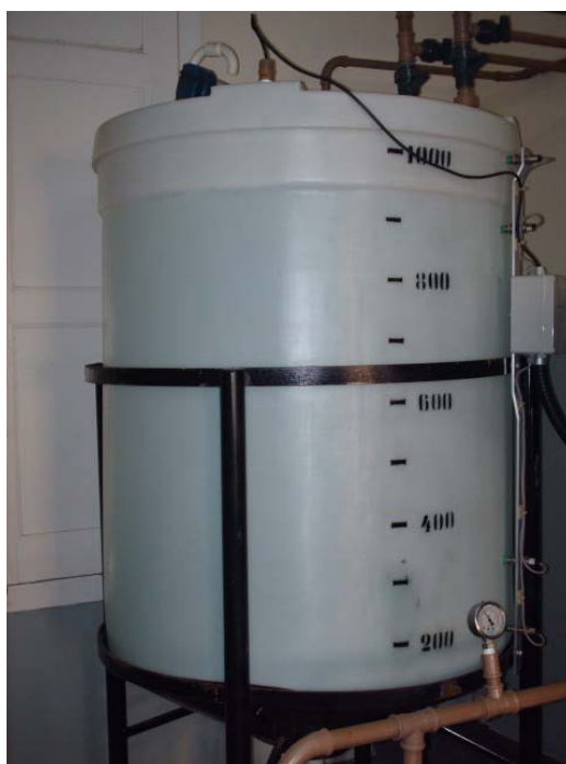
Figura 6.16 – Fotografia do reservatório de água purificada após osmose reversa. Fonte – Dados da pesquisa, 2007.
