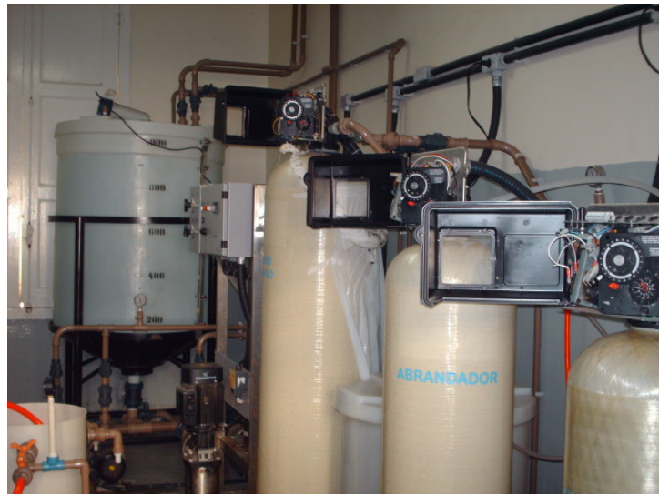
Figura 6.14 – Fotografia do Sistema de purificação da hemodiálise (deionizador, abrandador, filtro de carvão ativado e osmose reversa).
