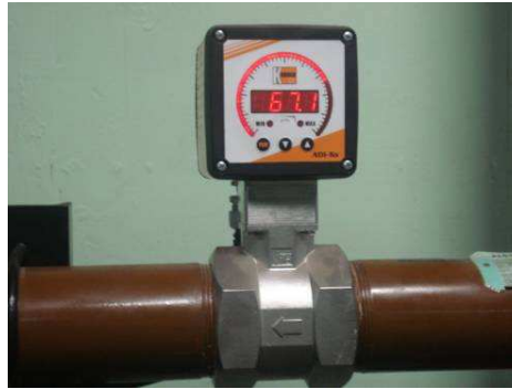
Fig. 5.7- Medidor de Pressão Diferencial
