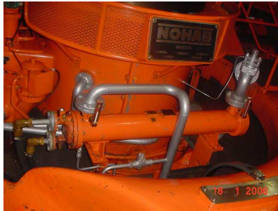
Fig. 4.5 - UHE Furnas Trocador de calor do mancal guia da turbina
