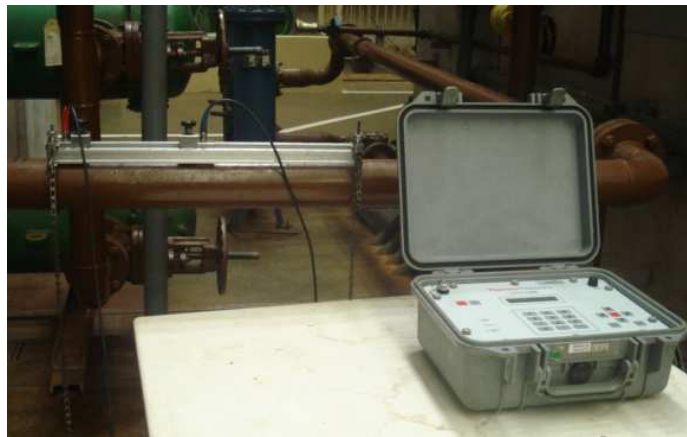
Fig. 6.4 – Medidor de vazão ultrassônico
