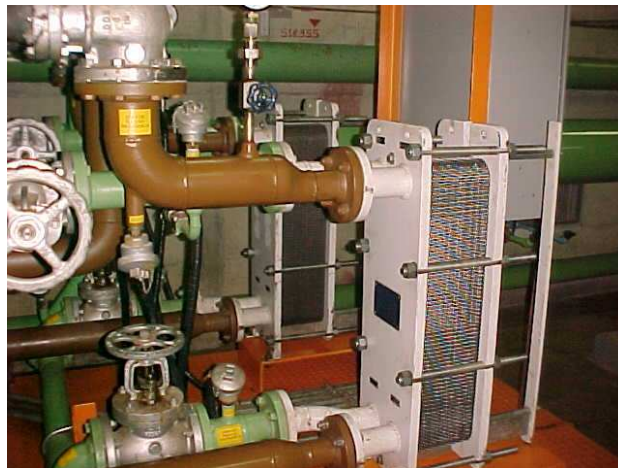
Fig.4.4 – UHE Corumbá -Trocador de calor do mancal escora
