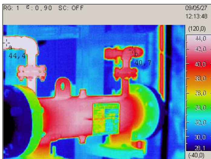
Fig 6.11 – Leitura de temperatura de entrada e saída de óleo do trocador de calor do mancal guia superior.
