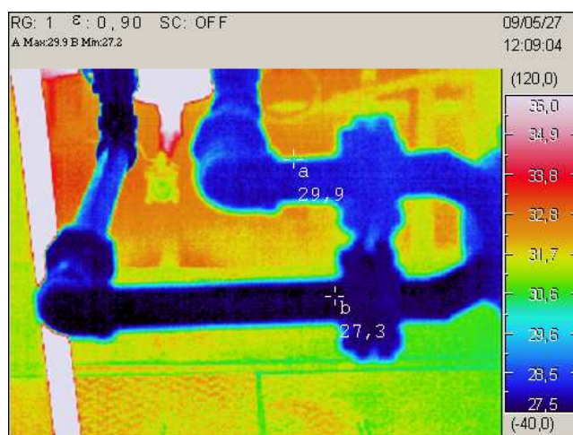
Fig. 6.5 – Temperatura do circuito de água do mancal guia superior
