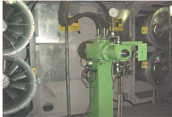
Fig. 4.2 – UHE Igarapava – Ventiladores externos
