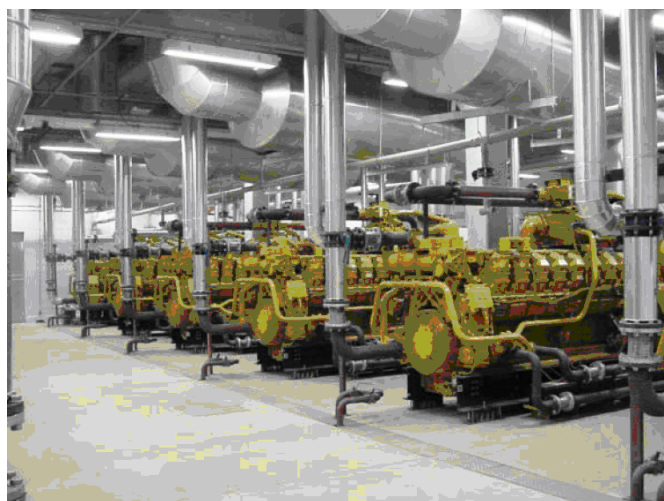
Figura 2.5 - Moto Geradores do Aterro Bandeirantes Fonte: COSTA, 2006.
