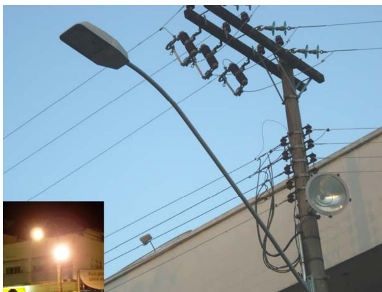
FIGURA 31 – Sistema de iluminação inadequado para fachadas.
