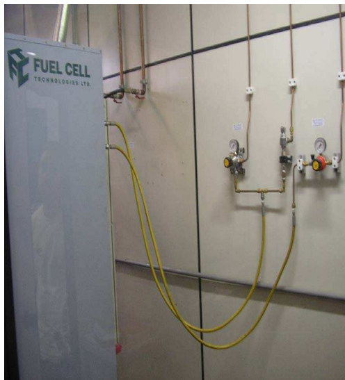
Figura 20 – Sistema de válvulas redutoras de pressão para fornecimento de combustível (a direita) e NHMix (esquerda).
