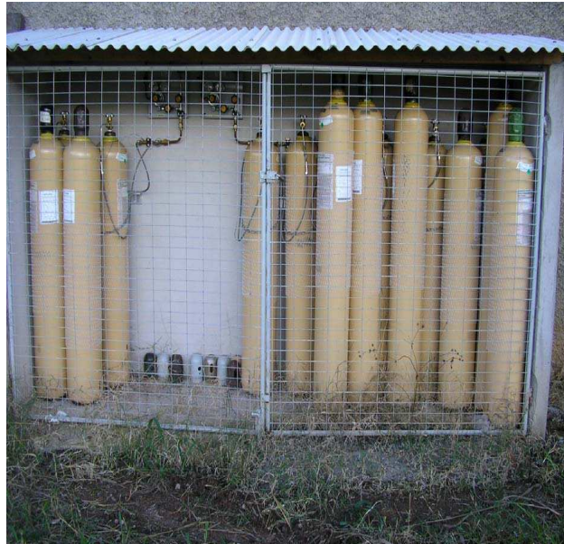
Figura 22 – Área da instalação para fornecimento de NHMix.
