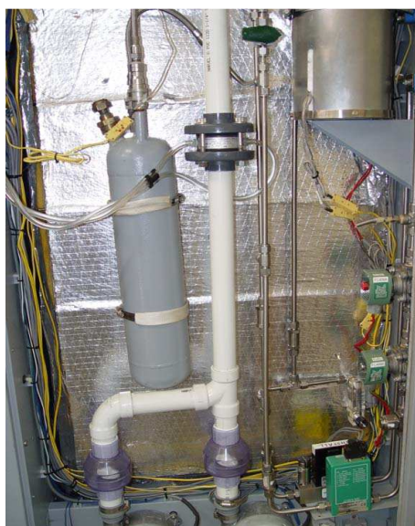
Figura 19 – Sistema de fornecimento de combustível (dessulfurizador, válvulas de controle de pressão e válvulas solenóide).
