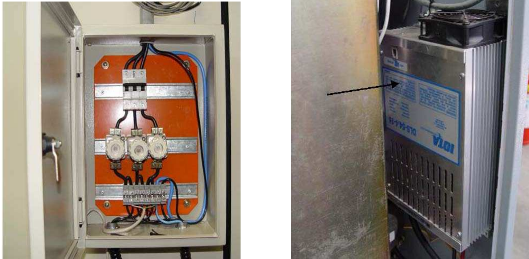
Figura 26 – Sistemas elétricos instalados.
