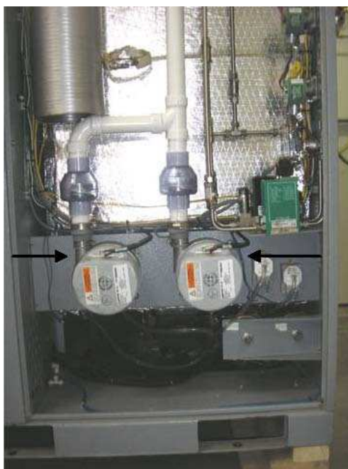
Figura 23 – Sistema de fornecimento de ar.
