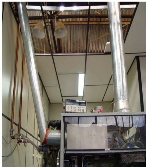
Figura 27 – Sistemas de ventilação e exaustão.
