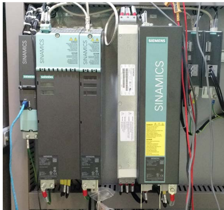
Figura 4.15 – Medição elétrica na saída do AFE.
