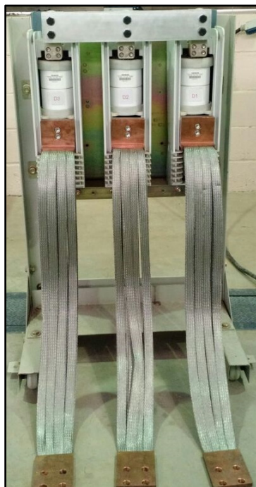
Figura 34 – Disjuntor utilizado para aplicação do curto-circuito nos terminais de baixa tensão no ensaio de elevação de temperatura. Fonte: autor.
