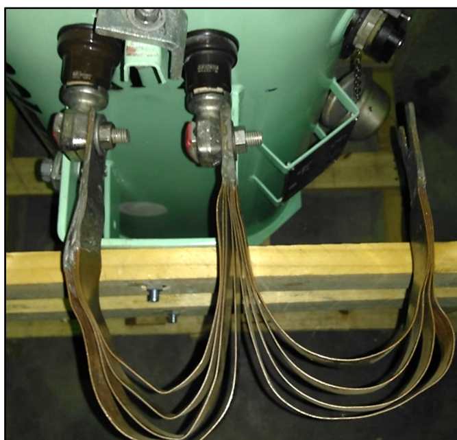
Figura 40 – Detalhe dos terminais de baixa tensão em curto. Fonte: autor.
