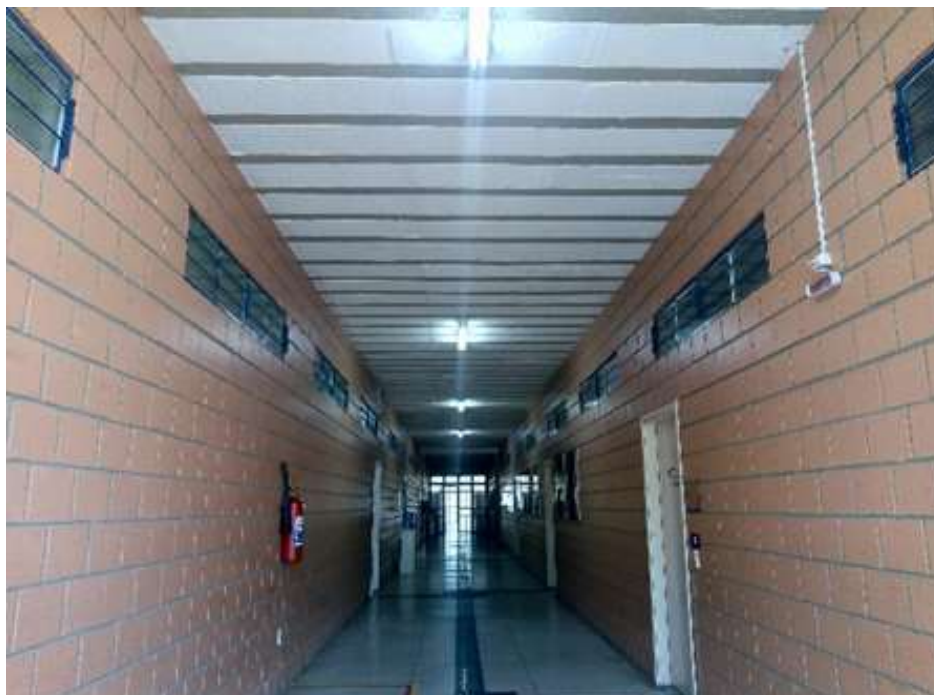
Figura 41 – Fotos do sistema de iluminação atual do corredor da UE-3
