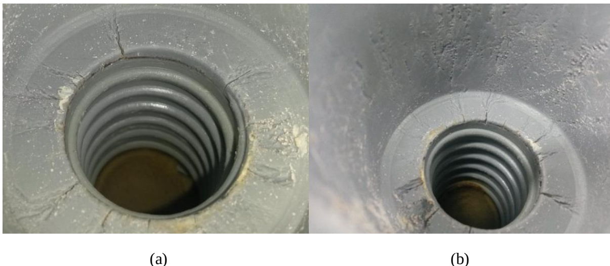
Figura 47 – Erosões internas próximas ao pino de sustentação do isolador.
