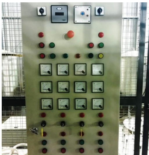
Figura 29 – Painel do sistema de controle
