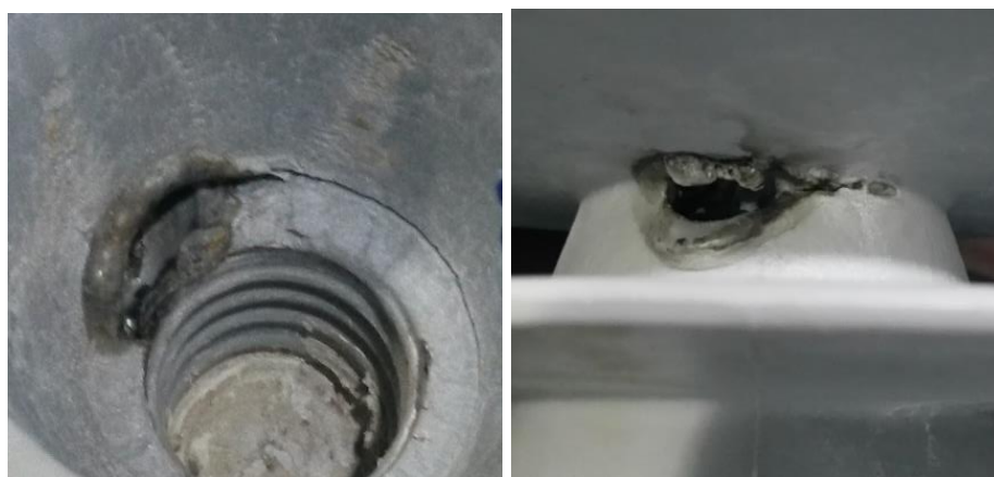
Figura 126 – Perfuração ocorrida no corpo do isolador do fabricante Y após 4000 horas.
