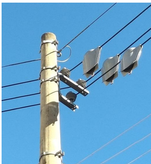
Figura 1 – Rede compacta com isoladores poliméricos.
