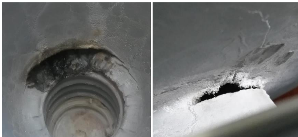
Figura 132 – Perfuração ocorrida no corpo do isolador do fabricante Y após 4500 horas.
