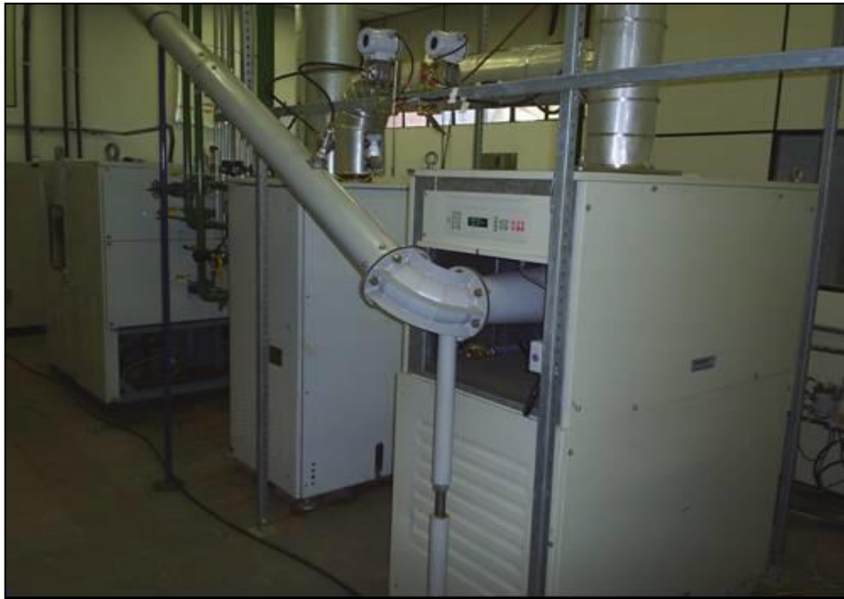
Figura 5.7 - Microturbina a gás Capstone C30 com duto de admissão.
