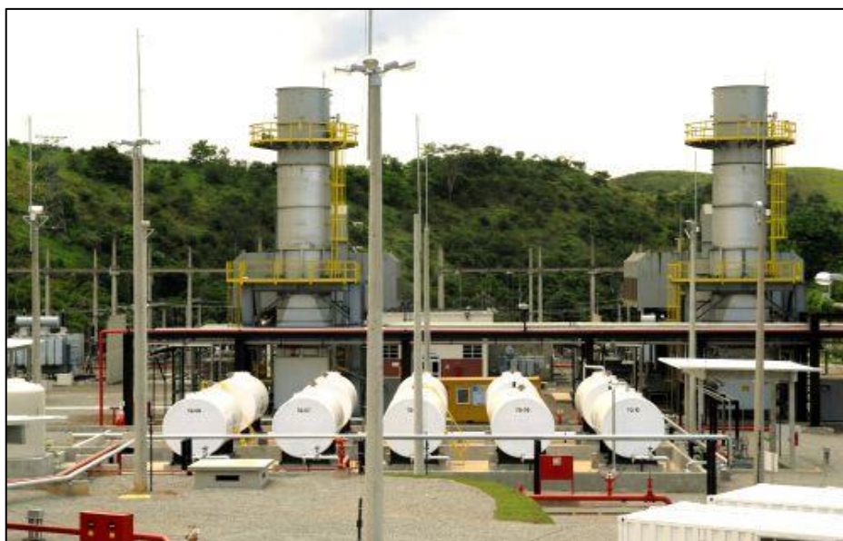
Figura 2.14 - Usina Termelétrica de Juiz de Fora (MG). Primeiras turbinas a gás em gerar energia elétrica utilizando etanol/gás natural.
