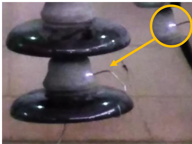
Figura 25 – Centelhamento ocorrendo no gap . Fonte: Próprio autor
