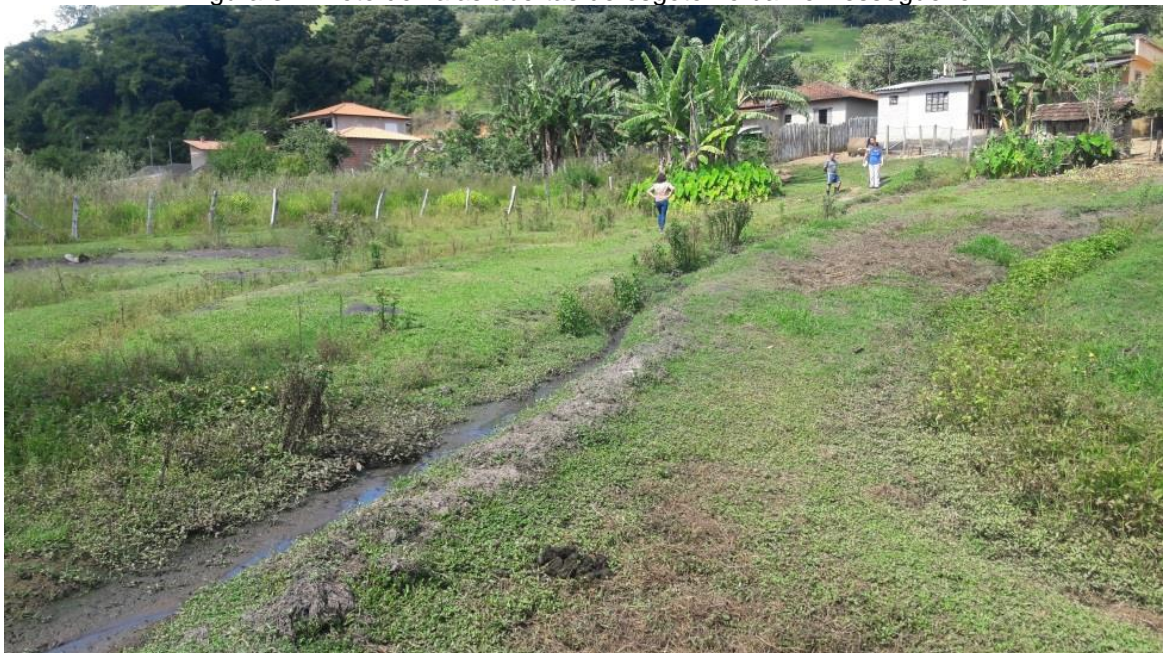
Figura 32 - Foto de valas abertas de esgoto no bairro Pessegueiro.
