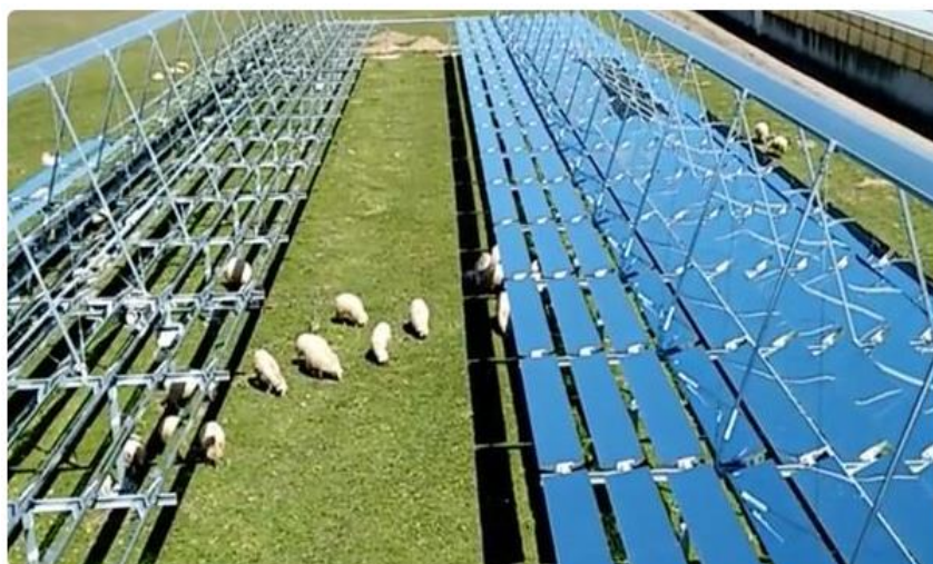
Figura 10 – Usina heliotérmica de San Nicolò de d’Arcidano (Itália)
