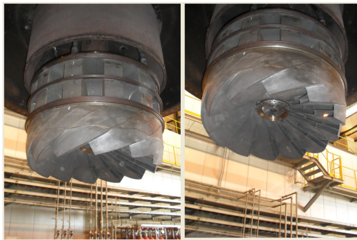
Figura 13 - Foto queimador e swirler da turbina a gás GT11N2 Alstom.
