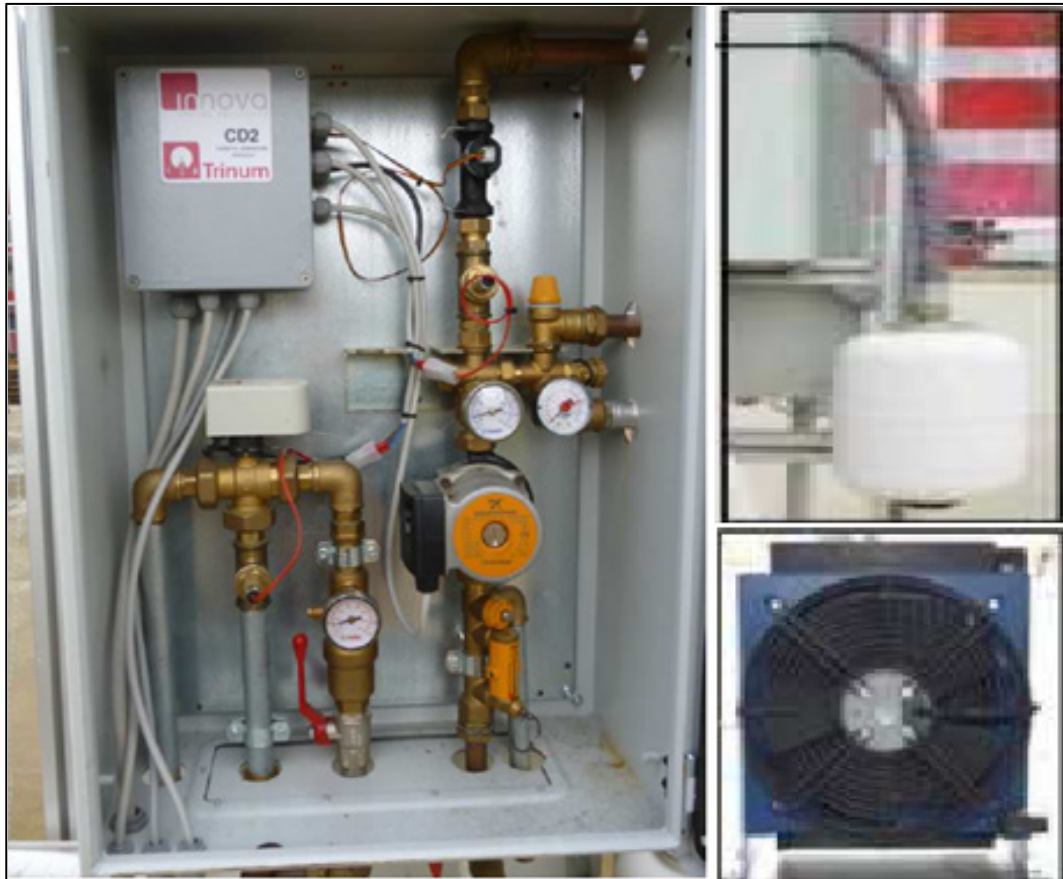
Figura 3.4 - Painel hidráulico, tanque de expansão e trocador de calor do Dish Stirling Trinum. Fonte: (INNOVA, APPLIED BRILLIANCE, 2014).
