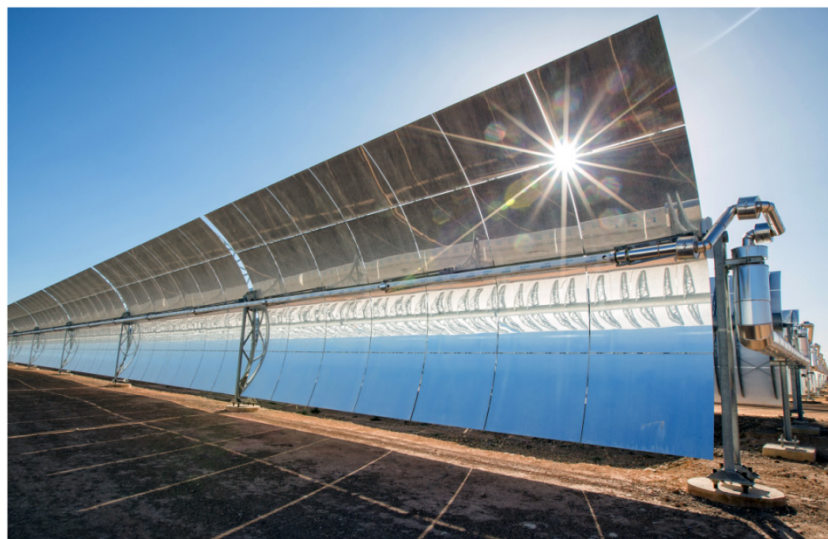
Figura 2.28 - Sistema Concentrador Cilíndrico Parabólico. Fonte: (PEREIRA et al. , 2017).
