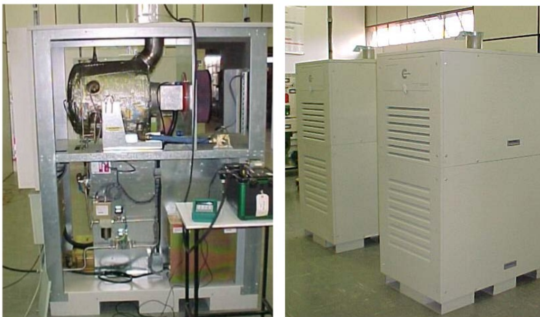
Figura 3.11: Microturbinas a gás da Capstone, modelo C30 do laboratório do NEST/UNIFEI.
