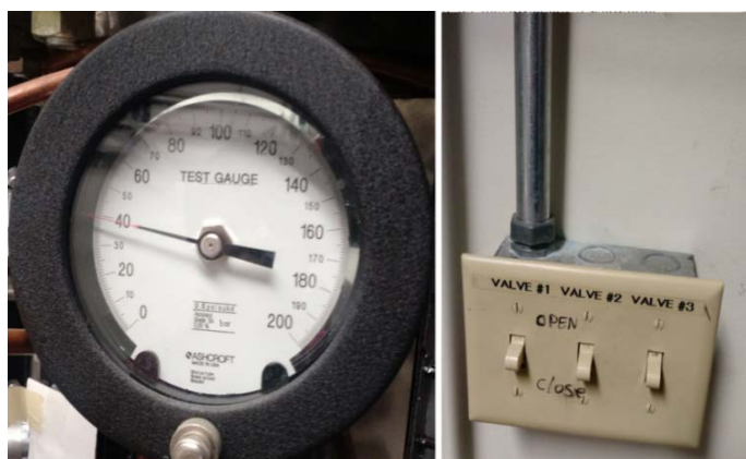
Figura 3.23: Válvulas manuais de controle da pressão.
