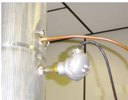
Figura 3.15: Medidor de temperatura na exaustão da microturbina a gás.
