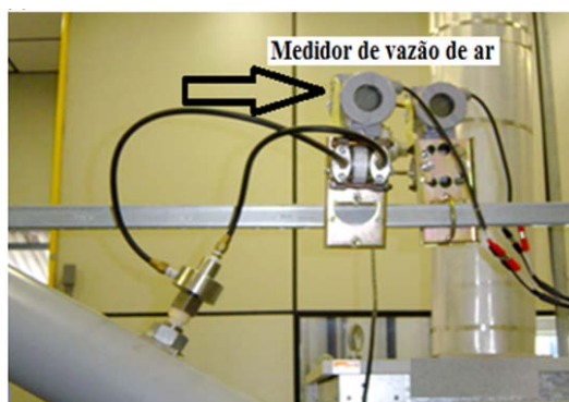
Figura 3.14: Medidor de vazão de ar instalado no tubo de entrada da microturbina.
