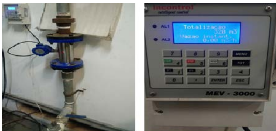
Figura 3.9: Medidor de vazão do gás pobre utilizado nos testes experimentais.
