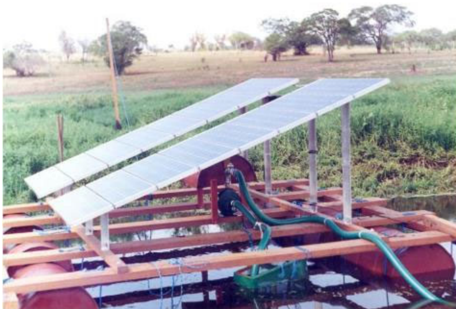
Figura 2.42 - Estrutura adaptada para apoio e fixação de módulos fotovoltaicos Fonte: (PINHO e GALDINO, 2014)
