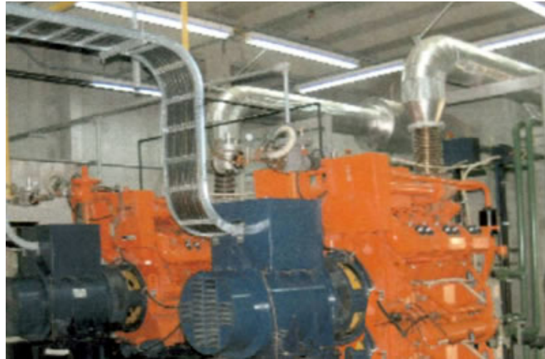
Figura 2.7 - Instalação típica de um motor alternativo. (P&D B08, 2004)
