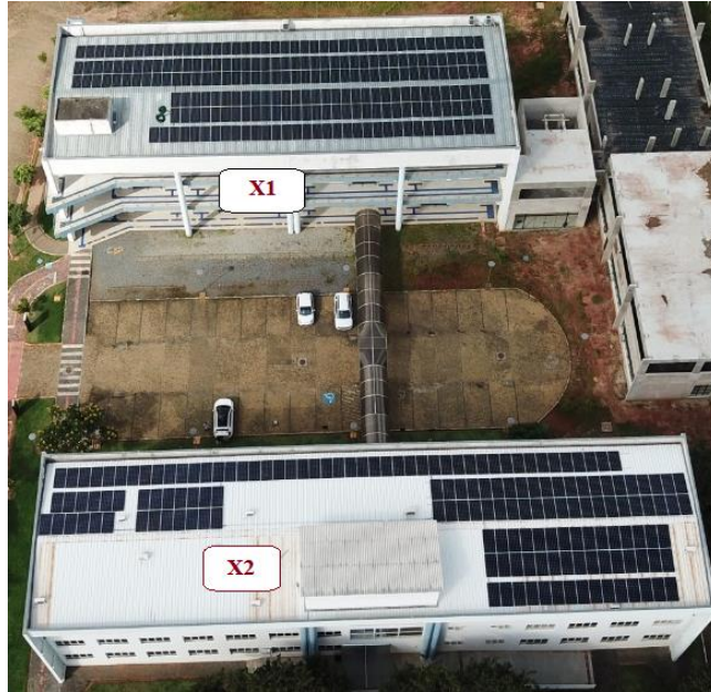
Figura 4.7 Sistemas fotovoltaicos instalados nos edifícios X1 e X2. Fonte: NESFV (2021)
