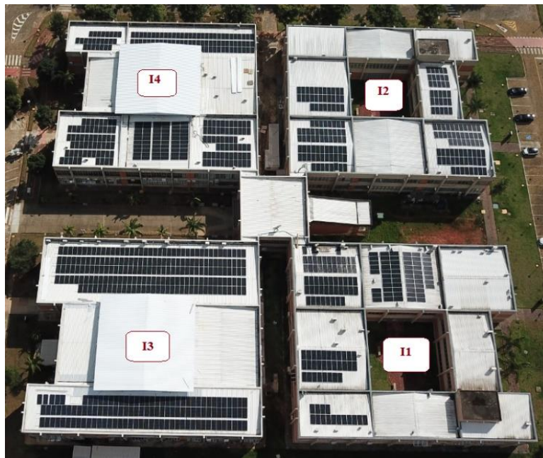
Figura 4.8 Sistemas fotovoltaicos instalados nos edifícios I1, I2 I3 e I4 Fonte: NESFV (2021)
