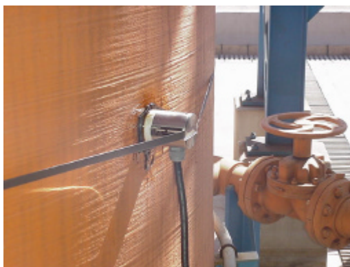
Figura 5.26– Instalação de sensor ultra-sônico em tanques de ácido.
