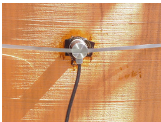
Figura 5.27 – Instalação de sensor ultra-sônico em tanques de ácido.
