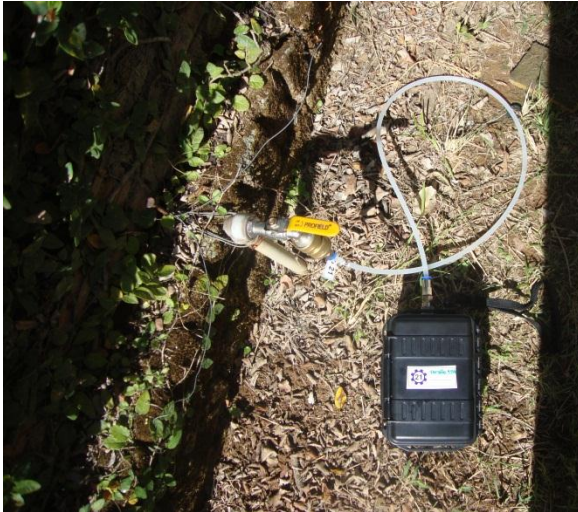
Figura 25 – Datalogger instalado em torneira residencial
