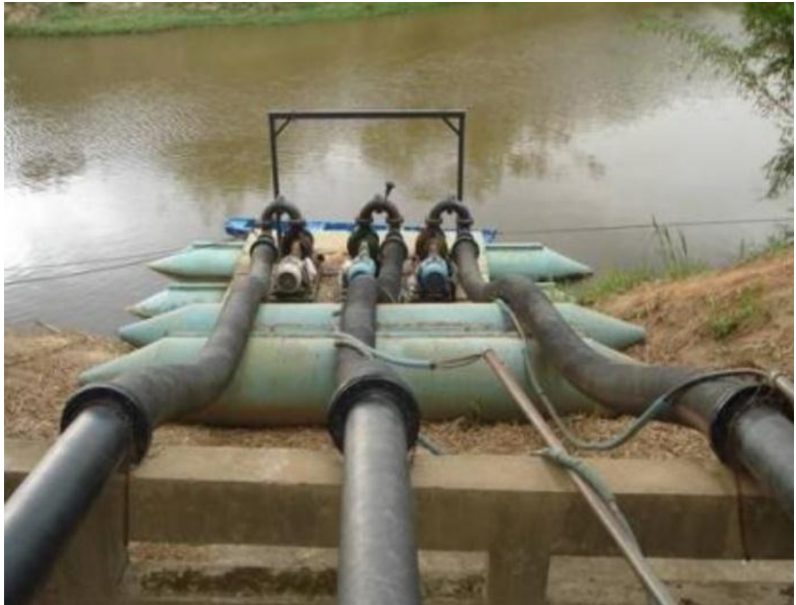
Figura 16 – Sistema de captação de água bruta.
