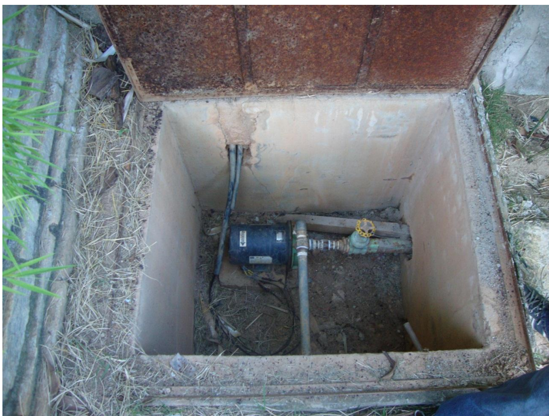
Figura 51– Booster localizado no bairro Moradas da Serra.
