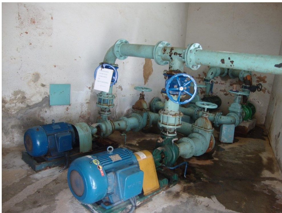
Figura 19 – Conjunto moto bomba que abastece o bairro Solar dos Lagos. O primeiro conjunto moto bomba (azul escuro) encontra-se desativado.
