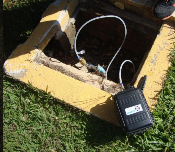
Figura 26 – Datalogger instalado em caixa residencial
