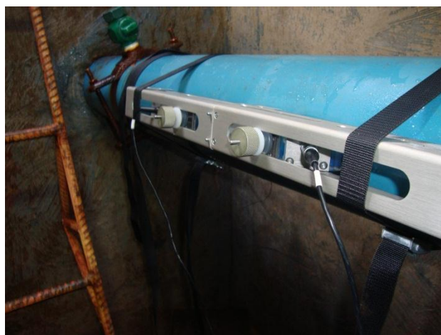
Figura 29 – Medidor ultrassônico instalado na Entrada do Setor em Poço de Visita
