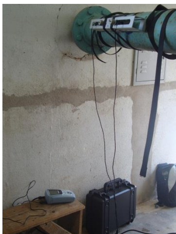
Figura 28 – Medidor ultrassônico instalado na Estação Elevatória Vila Nova
