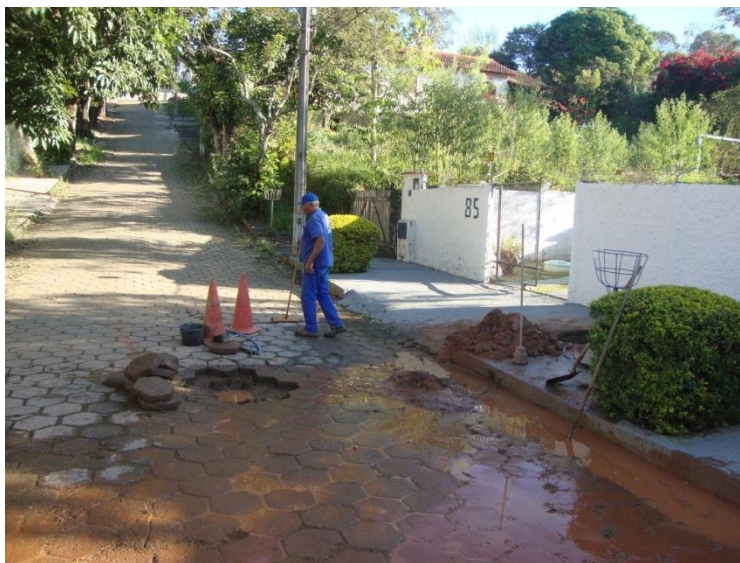
Figura 38– Vazamento ocorrido durante as medições.
