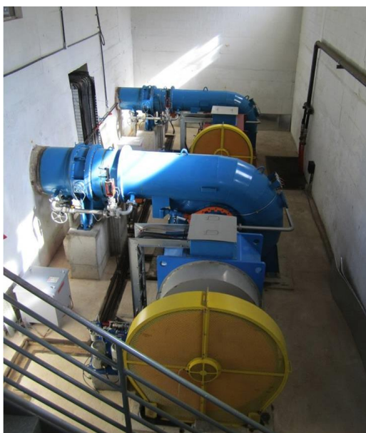
Figura 3-1 – Casa de força composta por duas turbinas francis simples horizontal
