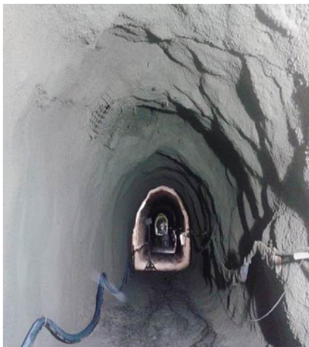
Figura 3-12 – Túnel com tratamento de tela metálica e concreto projetado (Fonte: PCH em Vereda – GMAIA Construtora)
