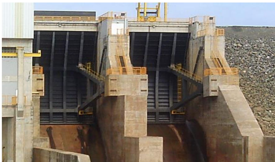
Figura 3-7 – Vertedouro controlado via comportas segmento (Fonte: UHE Barra do Brauna – DENGGE)
