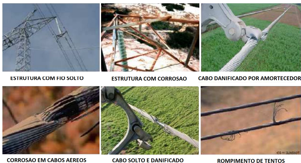
Figura 1 – Defeitos comuns em estruturas de linhas de transmissão de energia. Fonte: (SILVA, 2011) Adaptado
