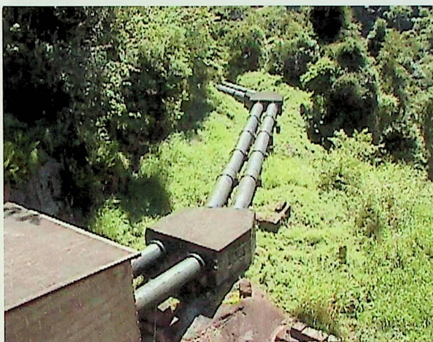
Figura 2.19 – Casa de Válvulas e início dos condutos forçados
