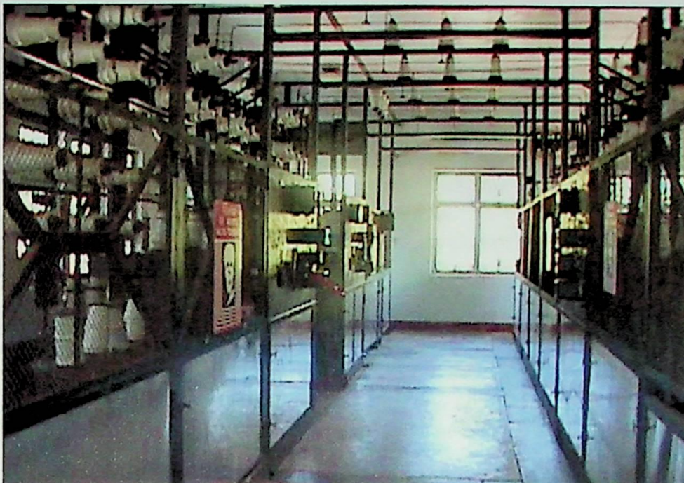
Figura 2.35 – Subestação elevadora 2º Piso, Equipamentos em 30 kV
