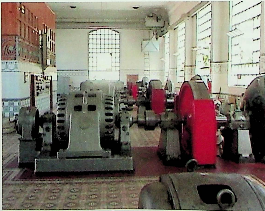
Figura 2.21 – Casa de máquinas da CP
