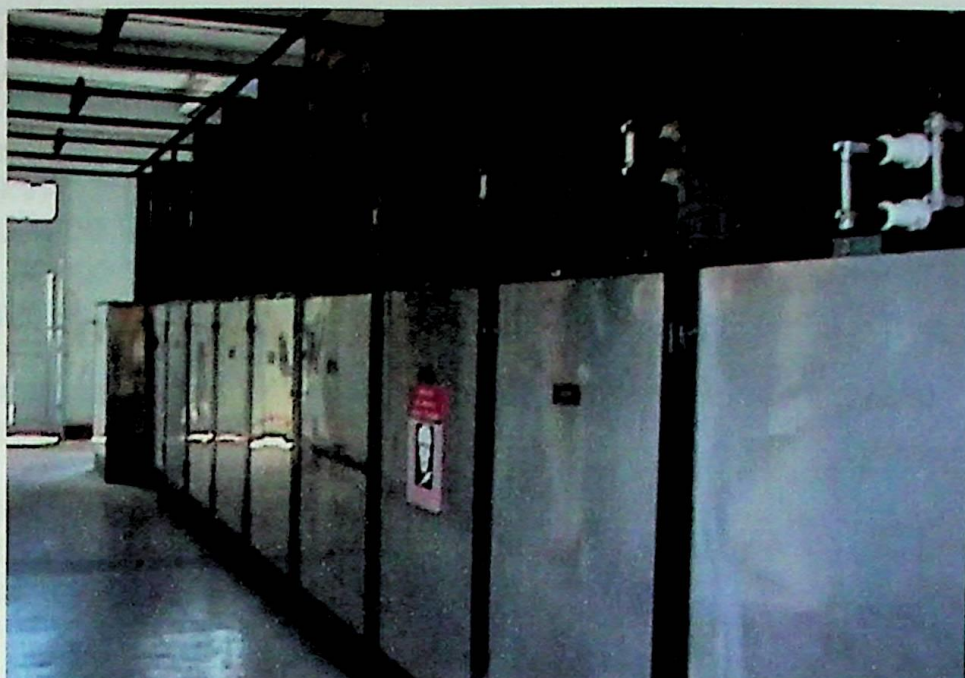
Figura 2.34 – Subestação elevadora - 1º Piso, Equipamentos em 2,2 kV
