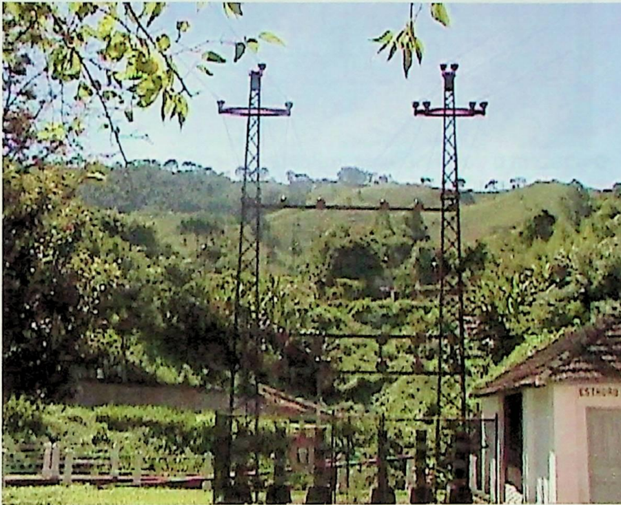
Figura 2.36 – Linhas de transmissão. Detalhe do pára-raios no solo
