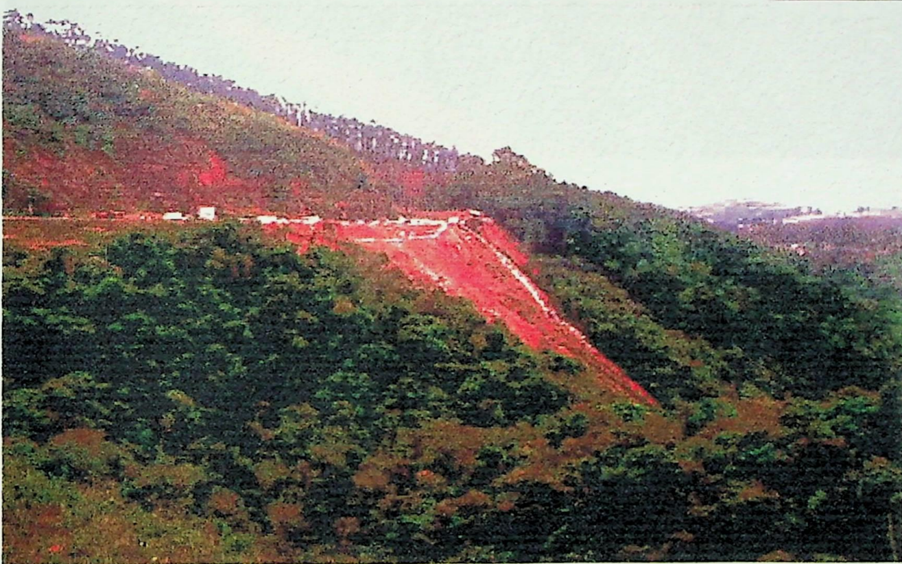
Figura 10 – Registro do passivo ambiental na rodovia SP – 88, km 46,3 Na Serra do Itapeti em Mogi das Cruzes – SP
