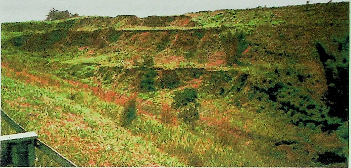
Figura 12 – Registro fotográfico de passivo ambiental em área de bota – fora localizada junto à praça do pedágio da Rodovia Ayrton Senna em Guararema – SP
