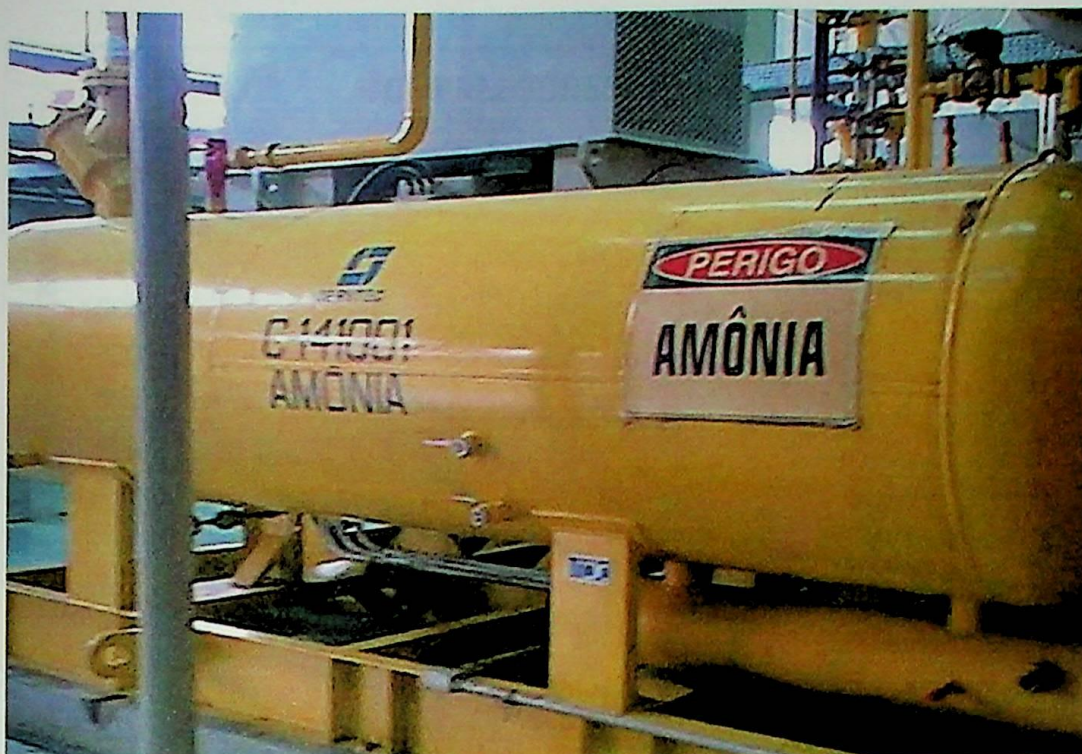
Figura 7.3 – Unidade de compressão sistema de amônia
